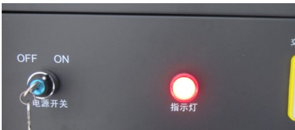
图 5.7 系统柜电源开关
